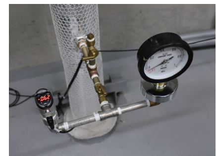
地下の備蓄倉庫内にある汚水・雑排水配管に水圧センサーを設置し、ZETA通信を利用して配管づまりの検知に活用している
