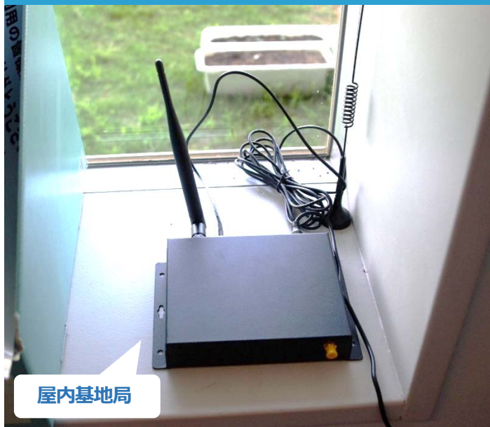
基地局 @ 1F/事務室
